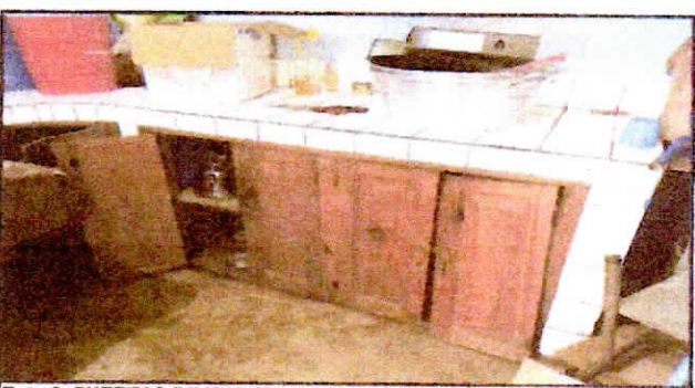
Foto 6: PUERTAS DE MADERA EN MAL ESTADO
