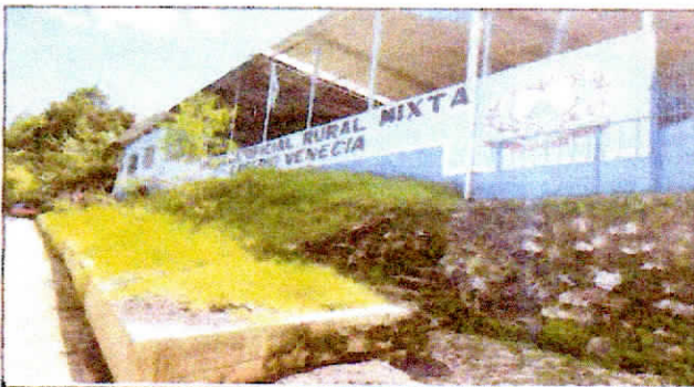
Foto 3: MURO PERIMETRAL EN RIESGO DE COLAPSO, ES POR ELLO QUE SE REFORZARA
